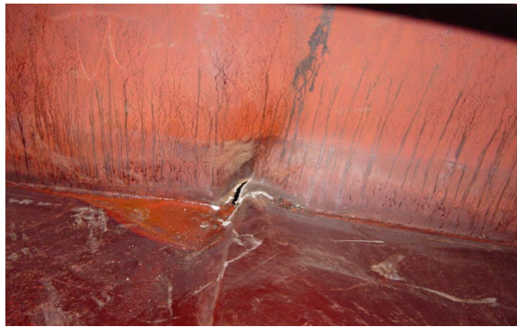
図 4.2-6 ポンツーン変形、ポンツーン内油浸入
