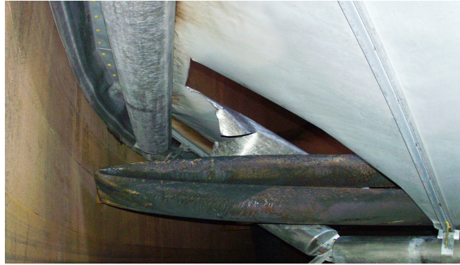
鎮火後のタンクの内部浮き蓋の状況
