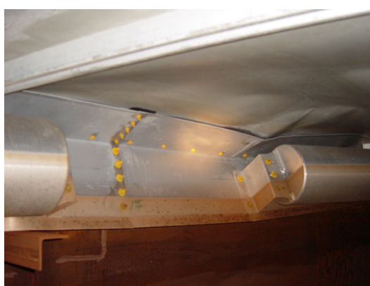
図 4.2-2 アルミ製浮き蓋変形
