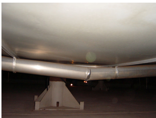
図 4.2-1 アルミフロートパイプ破損
