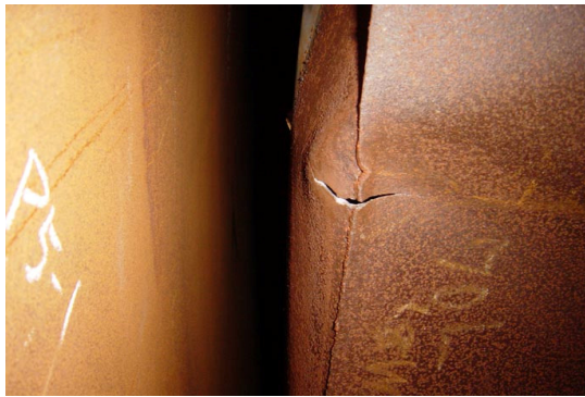
図 4.2-5 鋼製ポンツーン変形、開口
