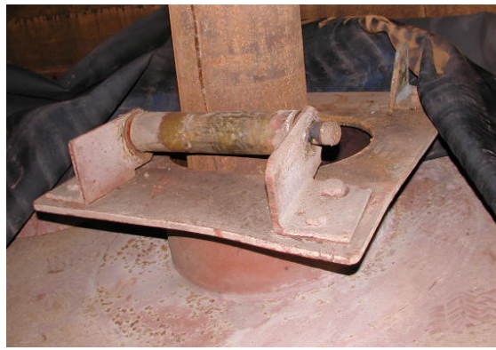
図 4.2-8 シールゴム破損
